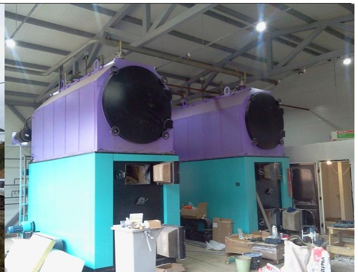
Рисунок 1.2.2 – Котлы в котельной
